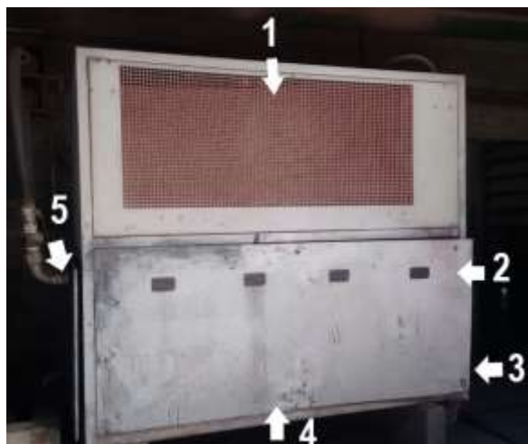
Figura 7: Chiller de condensação a ar em estudo.
