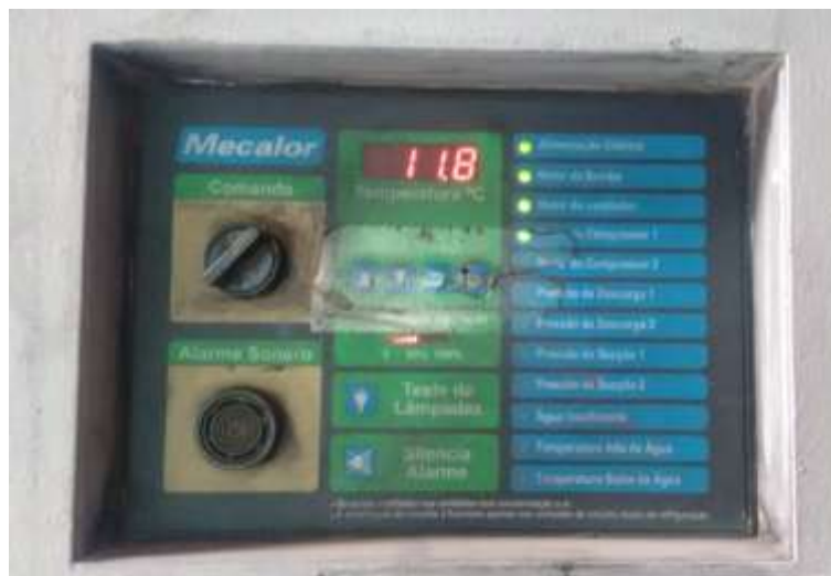
Figura 9: Leitura das temperaturas da água no chiller.
