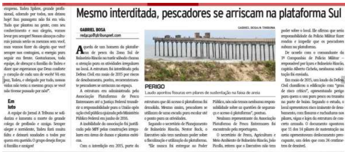
Figura 2: Plataforma é interdita por risco de desabamento
