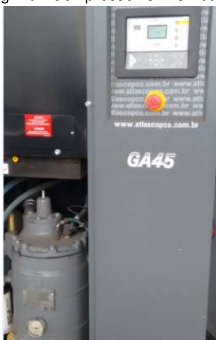
Fig. 10 - Compressor GA45 Atlas Copco
