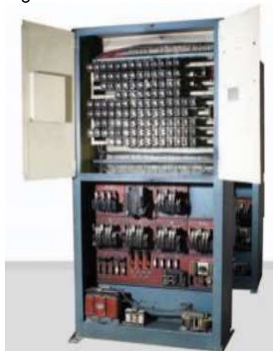
Figura 3: Quadro de comando a relé
