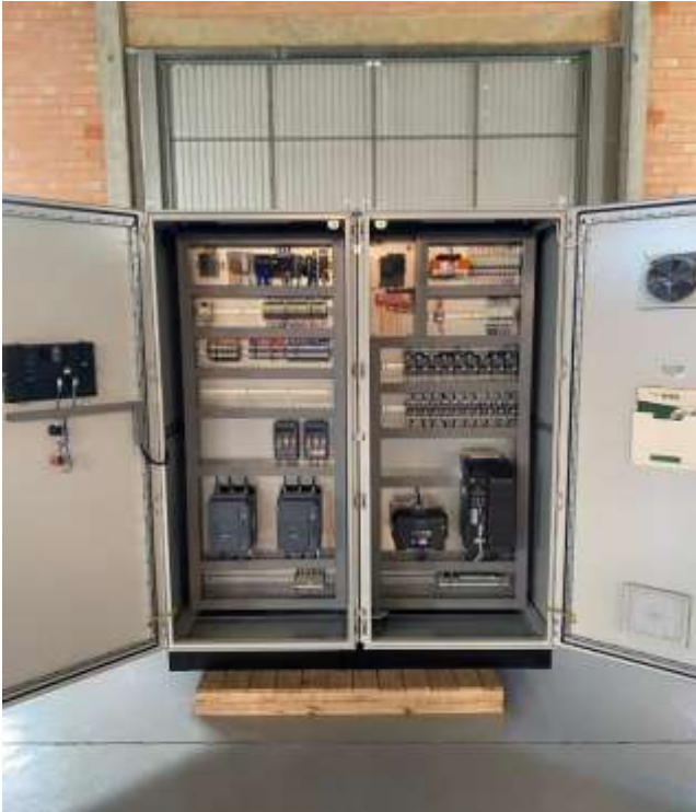
Figura 10: Visão interior do painel elétrico montado.
