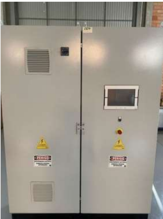
Figura 11: Visão exterior do painel elétrico montado.
