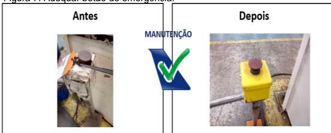
Figura 7: Adequar botão de emergência:
