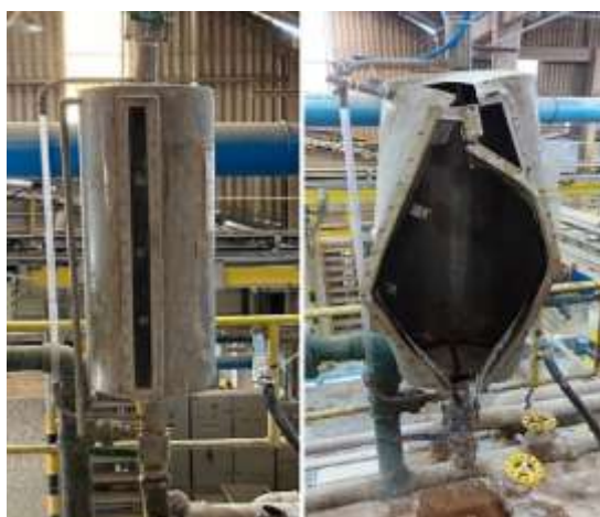
Figura 6: Tanque de dosagem de silicato.
